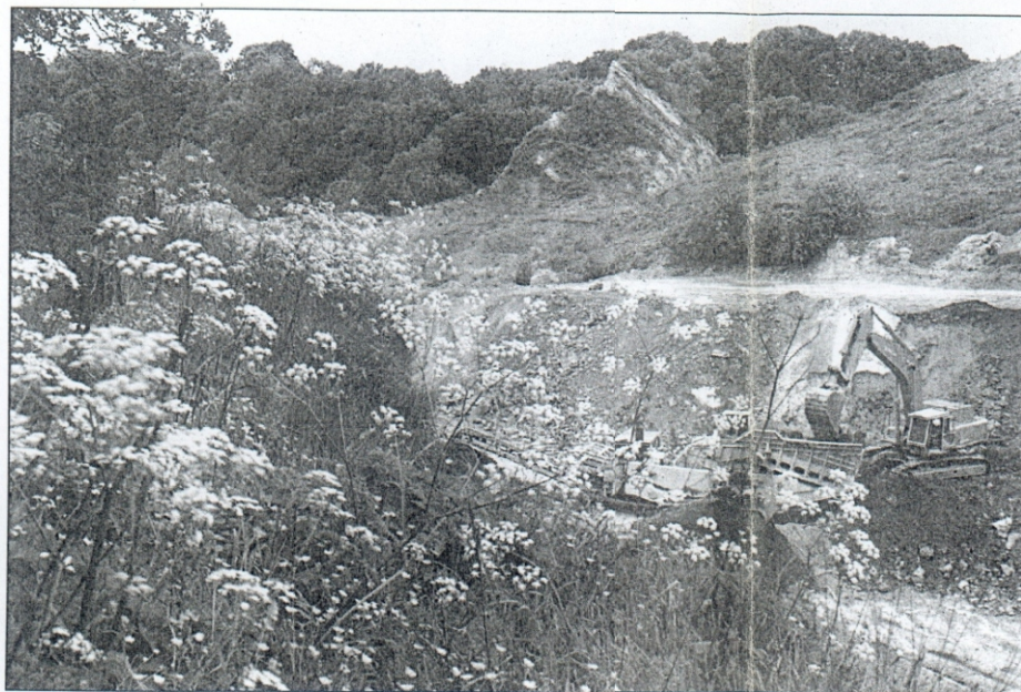
L'absence de permis d'extraction ne semble pas empêcher le carrier de continuer à exploiter son activité en toute illégalité.
